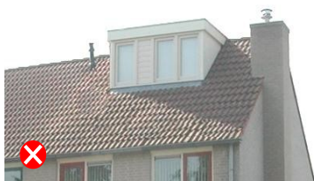
te hoog op het dak, profiel van de woning wordt aangetast
